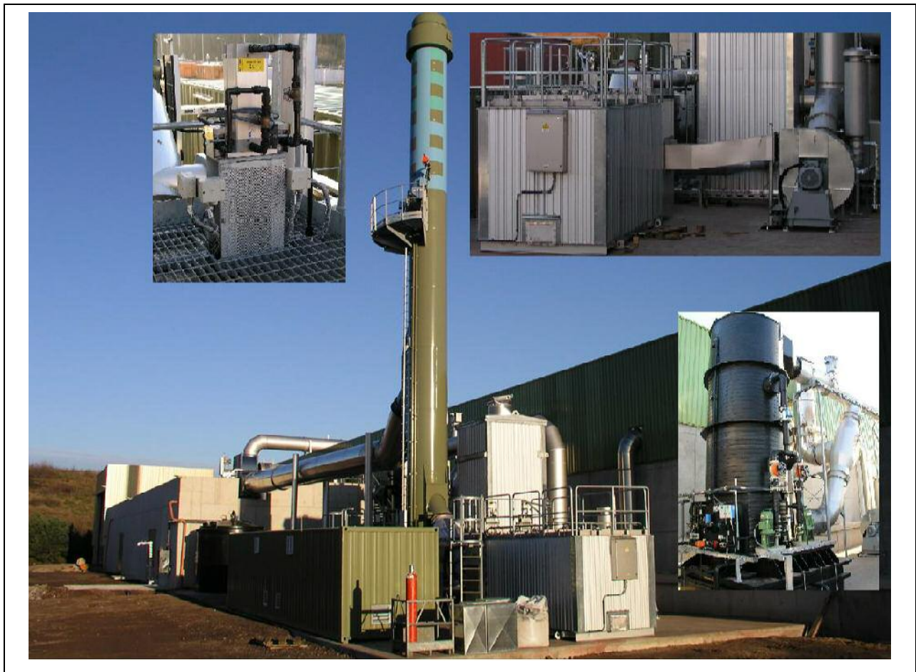
Abbildung 5 VocsiBox® zur MBA-Abluftreinigung
